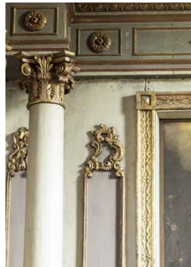
Lewa strona ołtarza głównego. Widoczne rozeschnięcia się połączeń stolarskich oraz zabrudzenia polichromii i wtórnej pozłoty.
