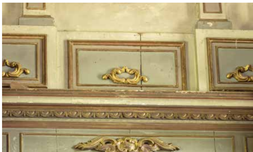
Górny fragment ołtarza głównego. Widoczne spękania i rozeschnięcia się połączeń stolarskich oraz ułamania gzymsów. Warstwa malarska w całości przemalowana, złocenia pokryte szlag metal.
