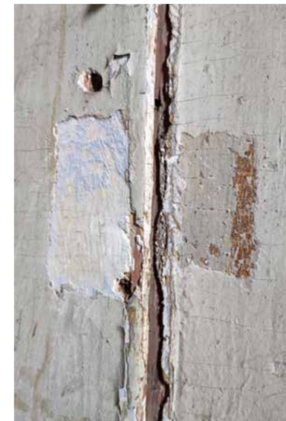
Fragment architektury ołtarza. Widoczne rozeschnięcia się połączeń stolarskich oraz liczne przemalowania farbami olejnymi w kolorach zielony, brązowy, błękitny na najstarszym opracowaniu bieli na gruncie.
