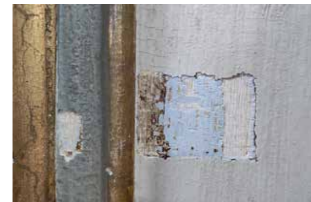
Fragment architektury ołtarza z odkrywką schodkową w warstwach wtórnych przemalowań. W najstarszej warstwie odkryto mocno spękaną biel na gruncie.
